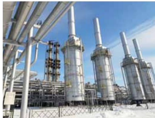
Трубчатые печи установки дезанизации конденсата
