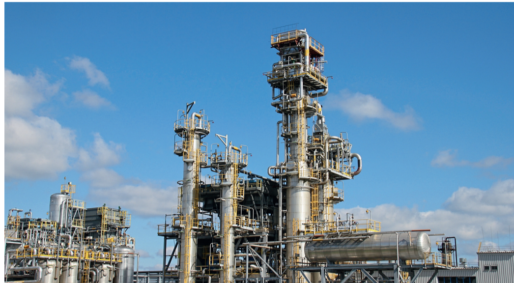
Цех № 8 — Сосногорский ГПЗ. Установка низкотемпературного разделения газа
