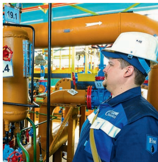
Вадим Ненашев, оператор товарный Сургутского ЗСК выявляет искусственно созданные несоответствия по ОТ и ПБ на технологическом оборудовании
