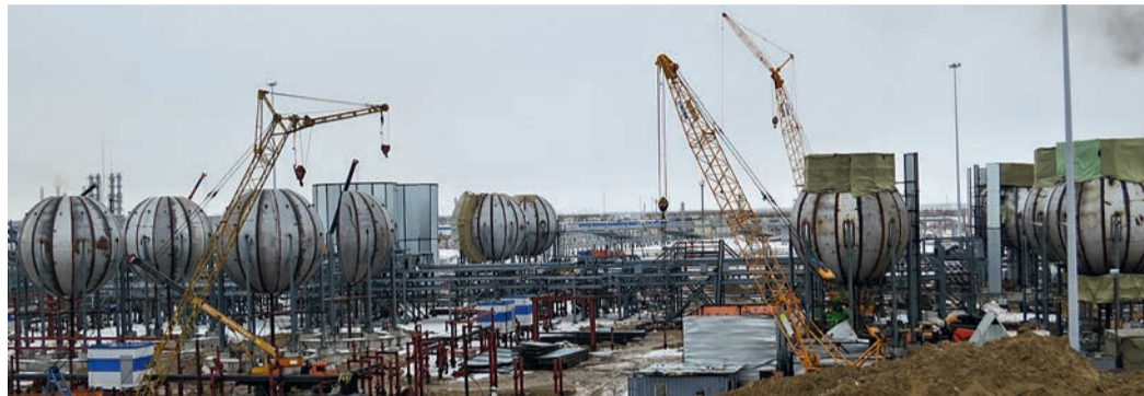
Площадка резервуарного парка дезанизированного конденсата головной насосной станции № 2. Объект «Расширение ЗПКТ — II очередь»
