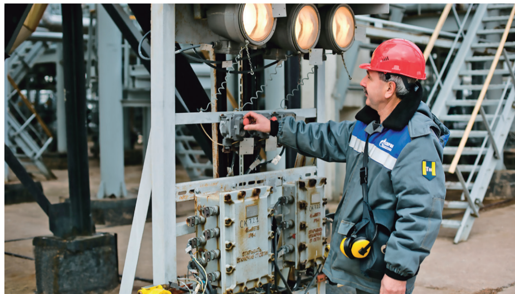
Приборист цеха КИПиА совершает обход постов системы контроля загазованности
