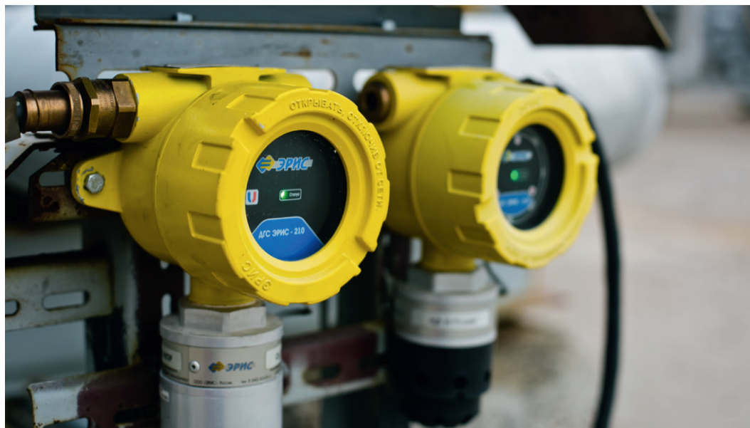
Датчики системы контроля загазованности заменены отечественными
