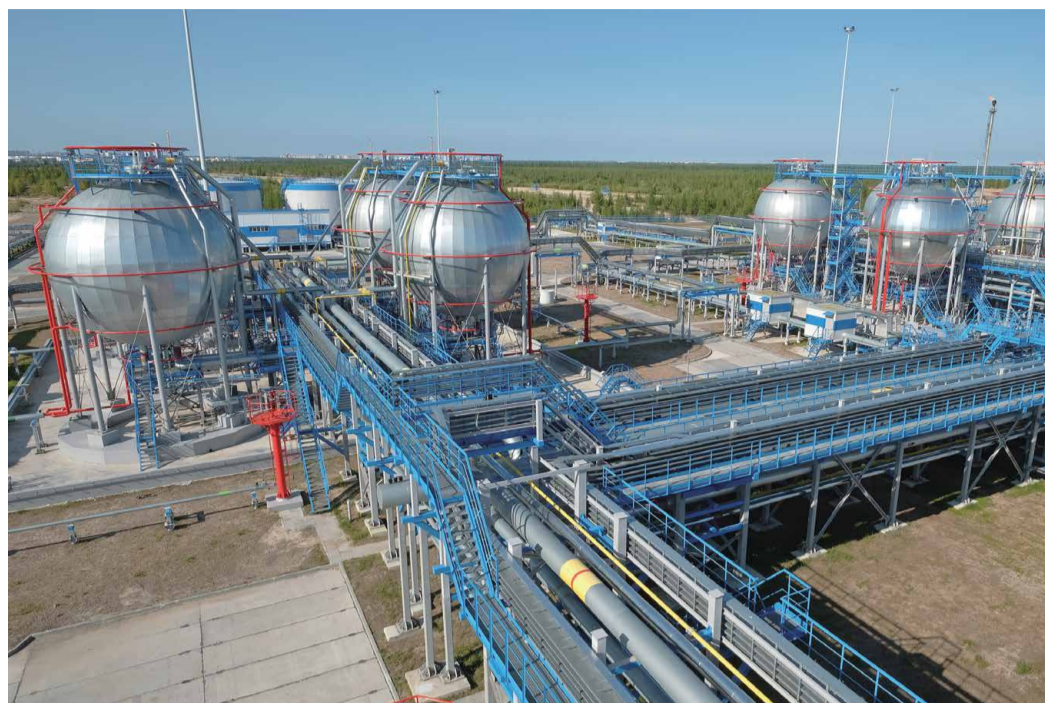
Парк шаровых резервуаров Завода по подготовке конденсата к транспорту
