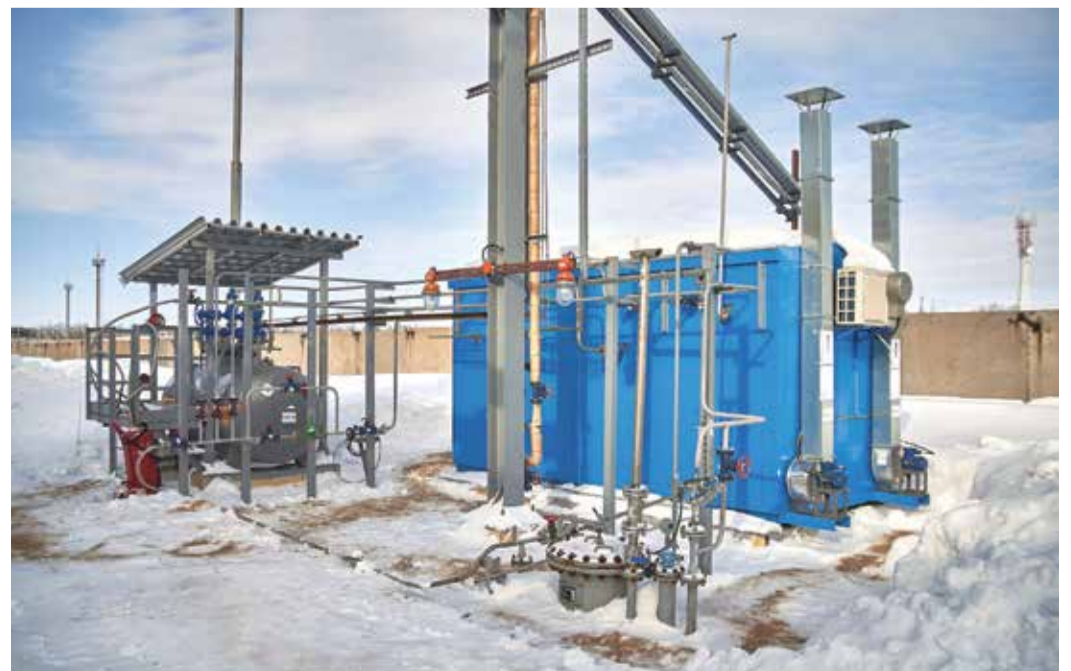
На оптимальный технологический режим выведен блок одоризации сжиженных углеводородных газов
