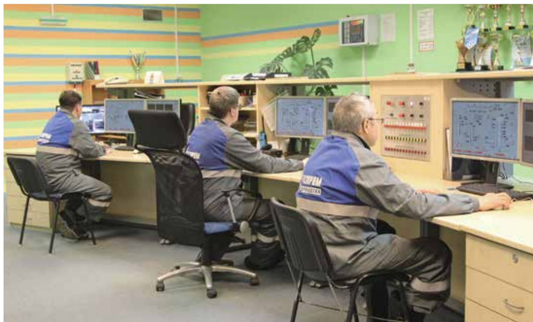
В операторной центральной пункта управления цеха № 8
