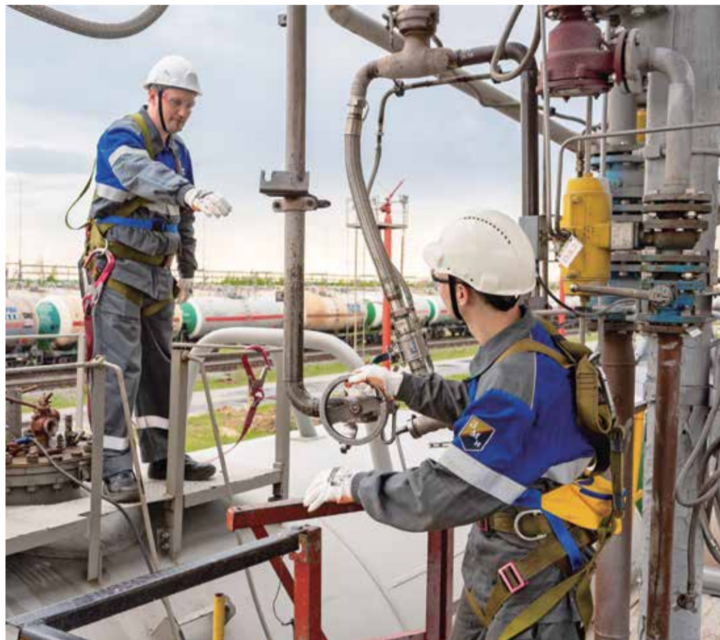
Отгрузка бутана технического на сливо-наливной эстакаде Сургутского ЗСК
