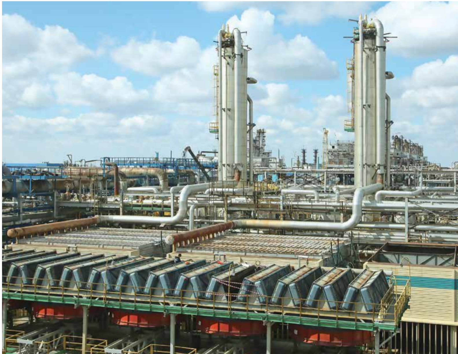
Установка очистки газа от сернистых соединений
