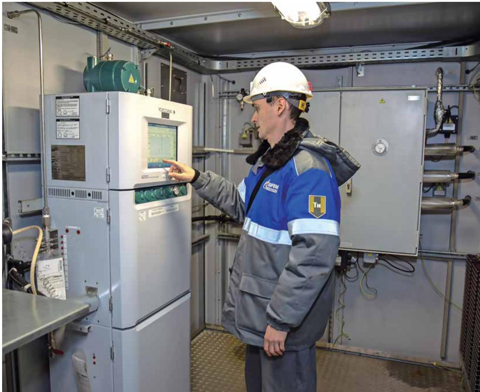
Станислав Жеребцов, инженер цеха АСУ ТП Сургутского ЗСК контролирует рабочие параметры хроматографа GC8000
