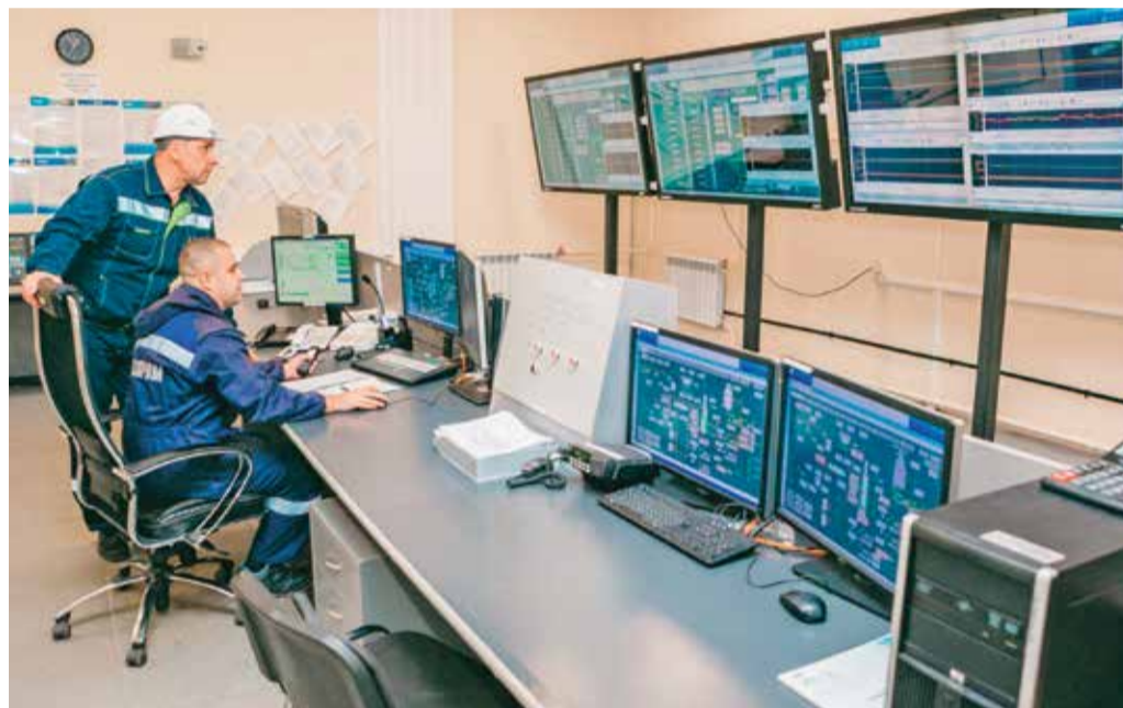
В операторной Установки стабилизации конденсата (УСК-3)
