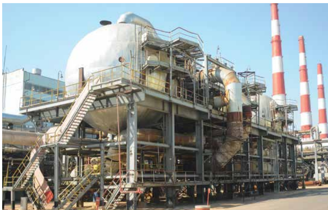
Установка доочистки хвостовых газов процесса Клауса
