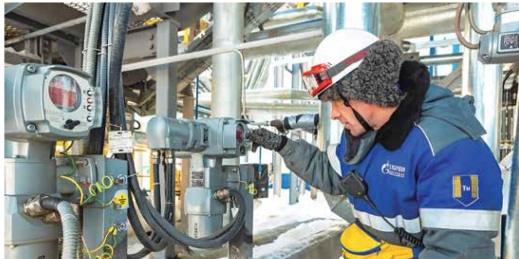
На территории установки очистки пропановой фракции Сургутского ЗСК
